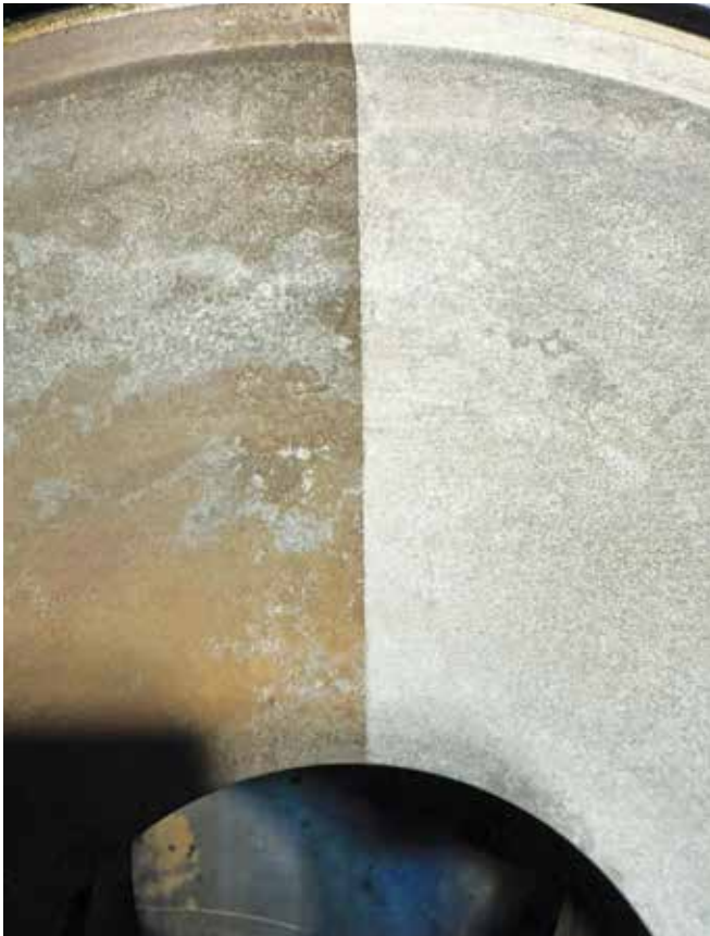
Slika 4: Blok črpalke – primerjava pred čiščenjem in po čiščenju (Lasten vir)
