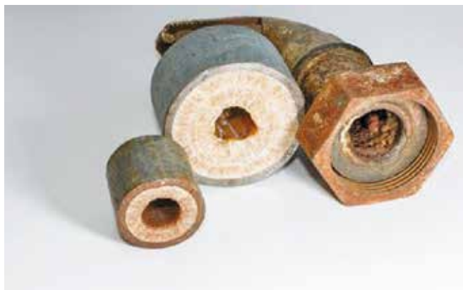
Slika 3: Korozija in kalcifikacija inštalacije STV (vir: https://www.arenainstalatililor.ro/fisiere/15024_p_10817_watts_oneflow_prezentare_ro.pdf )
