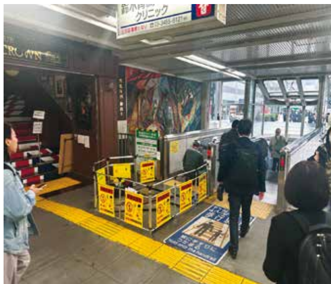
Vzdrževanje tekočih stopnic na Japonskem: varno in učinkovito vzdrževanje vedno in povsod
